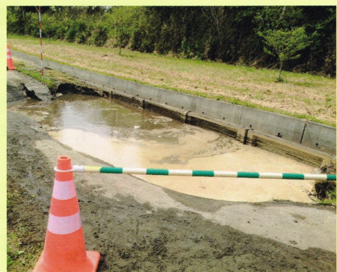
昨年度に大網白里市長国地先で起きた漏水事故
